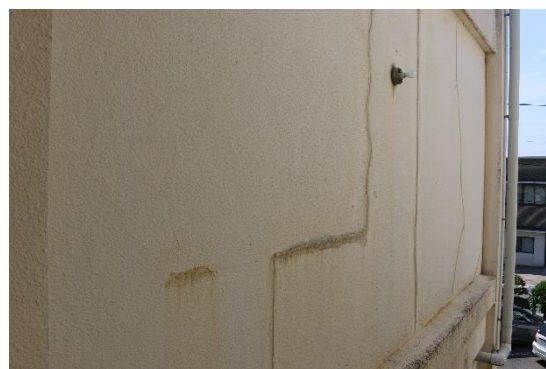
↑ 外部壁のひび割れ状況
