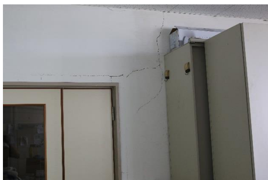
↑ 内部壁のひび割れ状況
